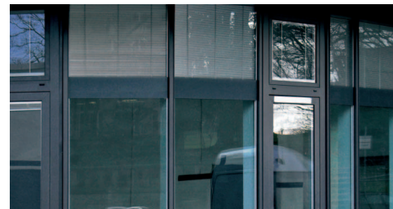
Im Erweiterungsneubau des Kasseler Elisabeth-Krankenhauses sorgen Sonnenschutzlamellen in den Isolierglasscheiben für Sonnen- und Blendschutz bei gleichzeitiger Lichtlenkung. Abbildungen: Kuzman
